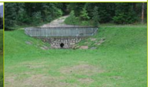
Beckenversickerung in Oberplanitzing, Kaltern
