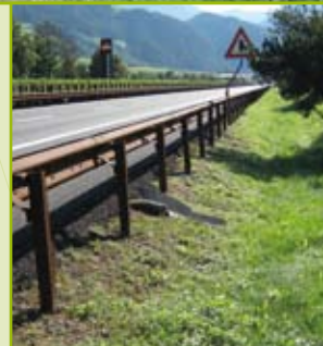
Muldenversickerung entlang der Brennerautobahn bei Trens
